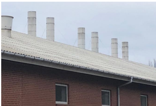
Eksempel på forhøjede ventilationsafkast
